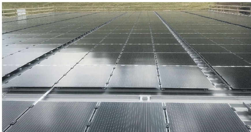
Das zwölfhundert Quadratmeter grosse Solardach auf der Reithalle des Klosters.
